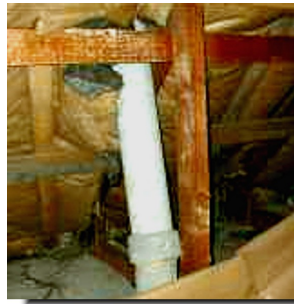
Figura 6 Canne fumarie in cemento-amianto
