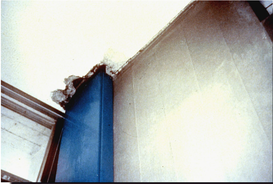
Figura 13 – Degrado spontaneo di solaio contenente amianto
