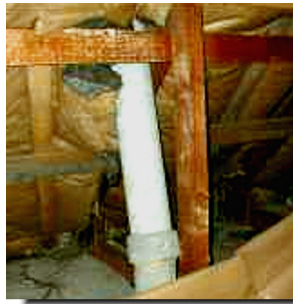
Figura 6 Canne fumarie in cemento-amianto
