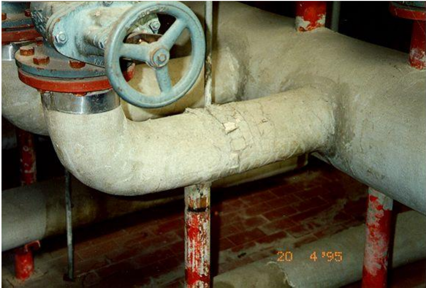
Particolare di tubazione rivestita con malta contenente amianto
