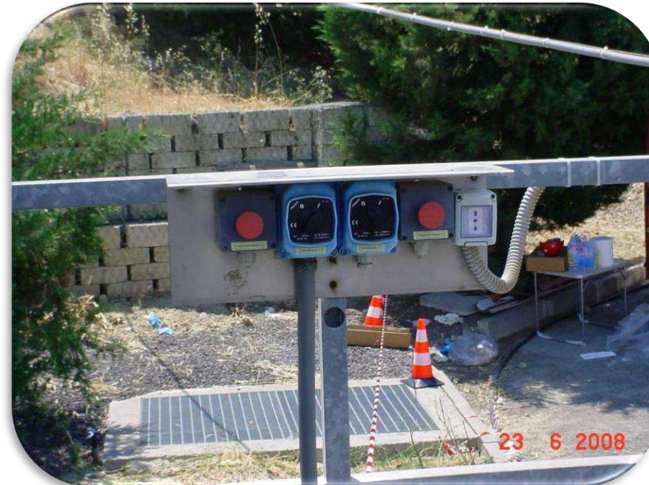
Comandi a valle della pompa di sollevamento dei fanghi
