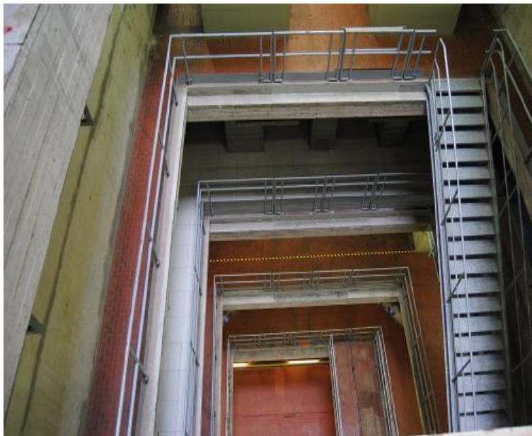
Foto di repertorio: pozzo delle scale di servizio interne alla centrale,
